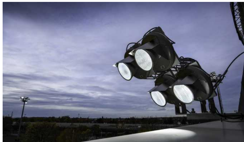
Een belangrijk aspect bij buitenverlichting is dat de armaturen bestand moeten zijn tegen verschillende schadelijke invloeden, zoals het weer, vandalisme en uv-straling
