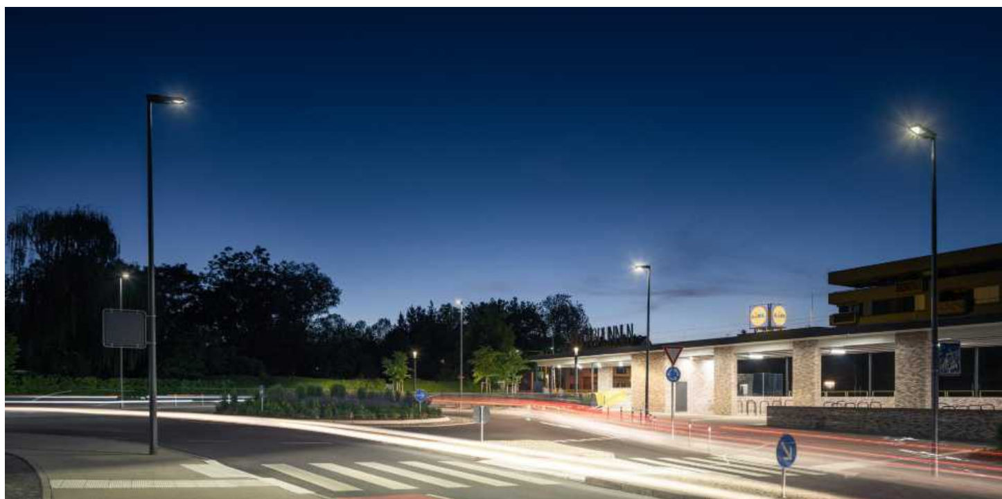
Lantaarnpalen langs de openbare weg zijn onderworpen aan strikte regelgeving
